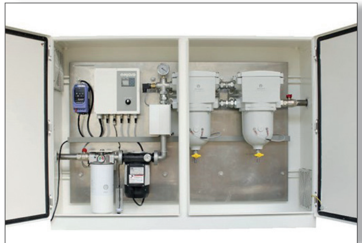
Standard diesel-filtreringssystem montert i skap.
